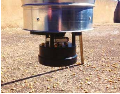
Motor do Distribuidor
